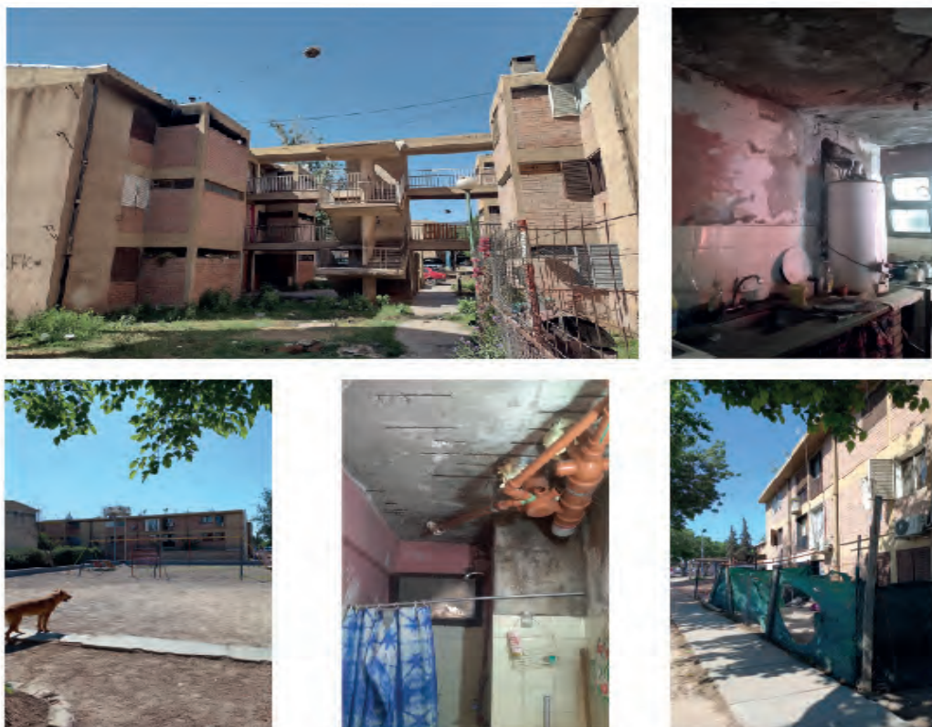
Figura 3. Imágenes del Huarpes II (2022). Deterioro de los conjuntos, presencia de basura y residuos, presencia de humedad y otros factores relacionados a riesgos para la salud
